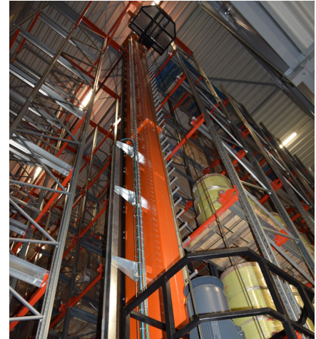
Voorkom inefficiënte piekbelastingen in je energievraag met peak shaving waarbij de opgeslagen remenergie kan worden ingezet om kortstondig piekvermogen te leveren. (Beeld: Siemens)
